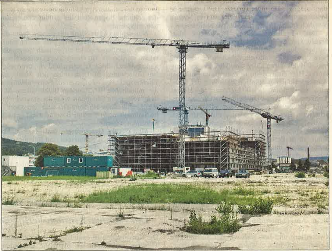
Das Färbi-Areal wird in Etappen überbaut. Im Hintergrund entstehen die ersten Gebäude. ELLEN MATHYS
